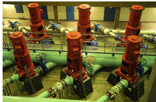
Netzpumpen mit 1000 m 3 /h Leistung befüllen die Hochbehälter
